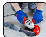
Poussières de béton et gravats
